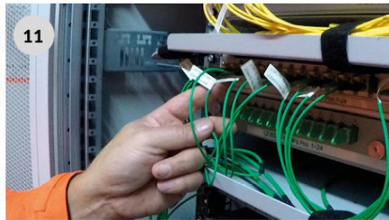
MA findet Kabel für Ausgang ZAM Kabel-Nr. LZ6202, Gleis 3, Nord
