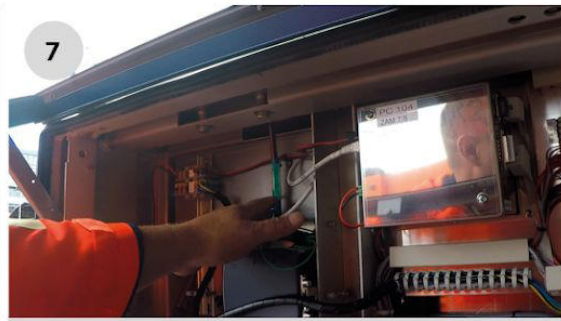
Kabel zu ODF (Optical Distribution Frame) zum Technischen Raum 1
