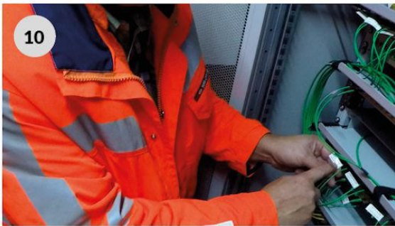
MA findet Kabel für Eingang ZAM Kabel-Nr. LZ6202, Gleis 3, Nord
